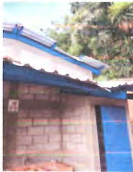
CUBIERTA DE LAMINA, CABIO DE LAMINAS EN PUNTOS ESPECIFICOS, MANTENIMIENTO DE ESTRUCTURA, CAMBIO DE CARGA LAMINAS DEFORMADO
